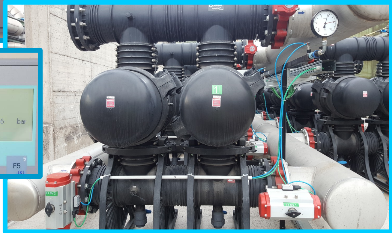
Filtrazione acqua di fiume ad uso industriale - AST Terni - Italia
